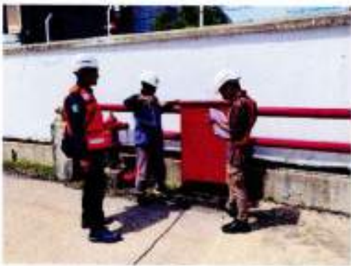
Pemeriksaan Cat Box Hidrant
