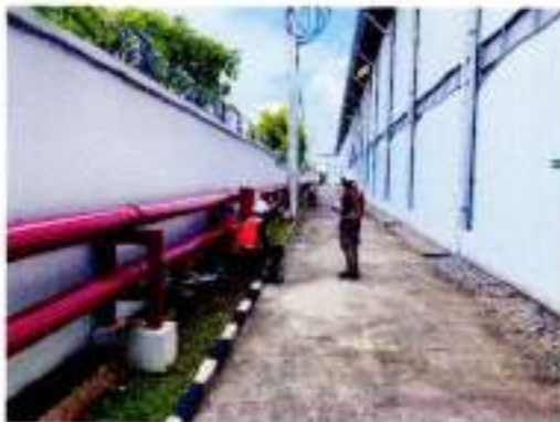
Pipa Hidran sisi Utara
